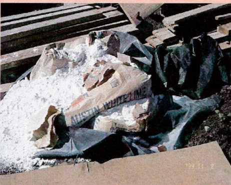
Construction Debris Escombros de la Construcción
