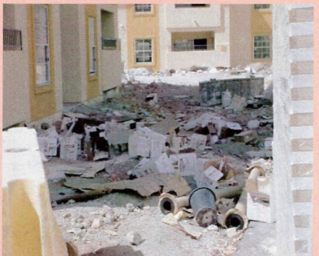
Poorly Maintained Construction Site Sitio de la Obra Mal Mantenida
